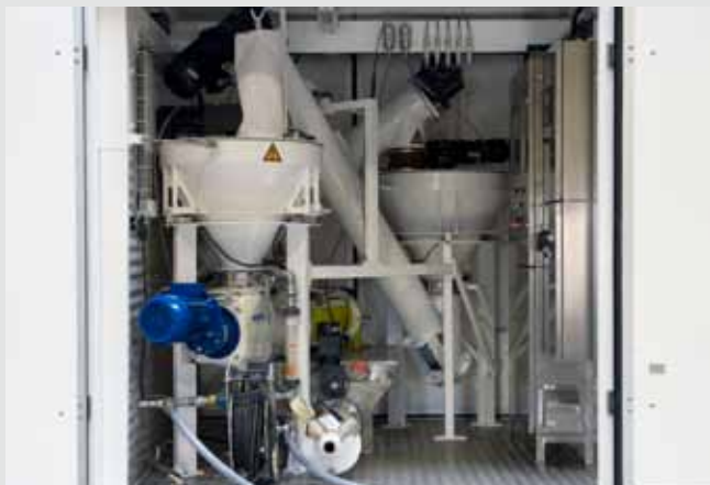
Pumpecontainerens blande- og pumpeudstyr
